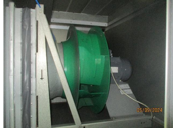
Kuva 8.6 TK05 suoravetoiset puhaltimet PM-moottorein, taajuusmuunta- jaohjatut
