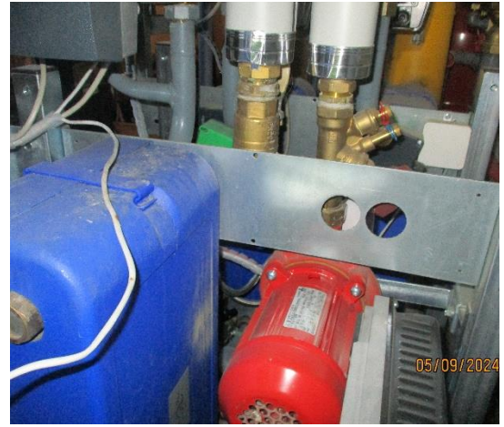
Kuva 6.2 Käyttöveden lämmönsiirrin ja verkoston pumppu.
