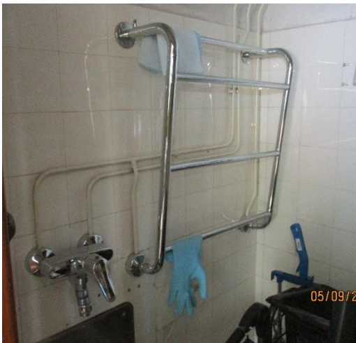
Kuva 6.14 Kellarin B-osan siivoussuikun käyttövesipatterin liitoksissa hapettumaa sekä alkavaa tihkuvuotoa.
