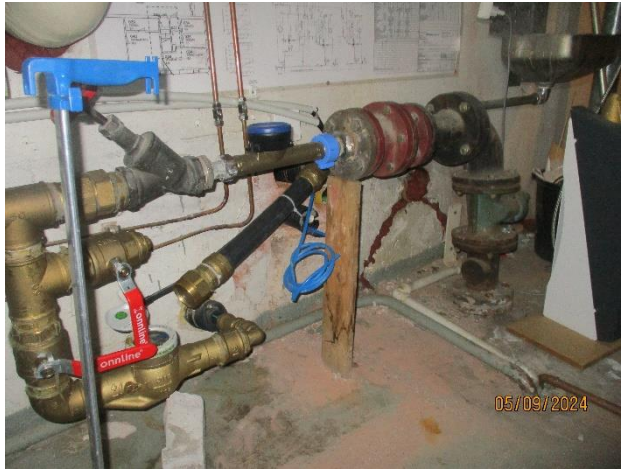
Kuva 6.1 Vanha valurautainen tonttijohto, päävesimittari ja -sulku teknisessä tilassa. Kannakoinnit puutteelliset.
