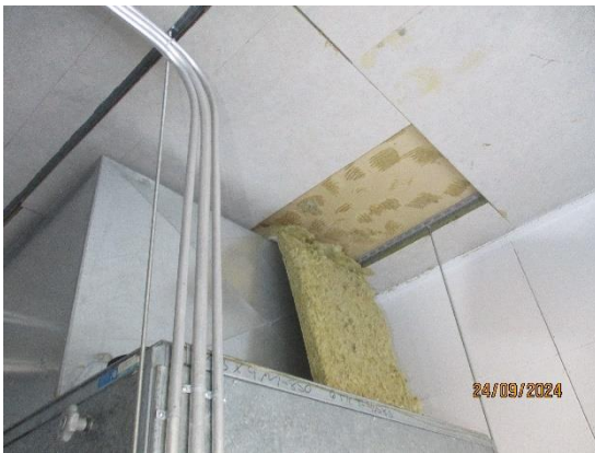
Kuva 8.7 IV-konehuoneissa paljon epäpuhtauslähteitä, toimii mahdollisesti kuitulähteenä.
