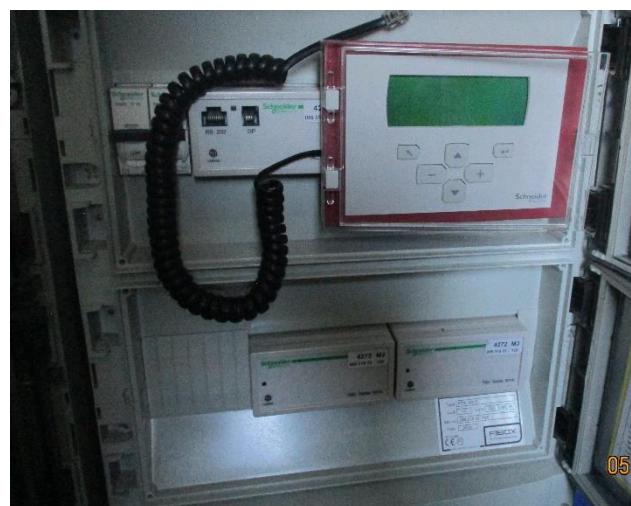
Kuva 8.18 VAK1 sisältää kaukolämmön alajakokeskuksen ohjaukset.
