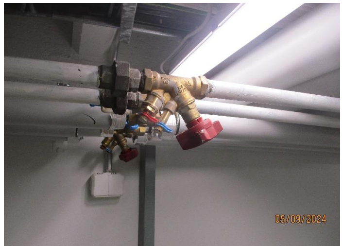
Kuva 5.6 Lämmitysverkoston uudempia putkistovenntiileitä kellarin B-osalla.
