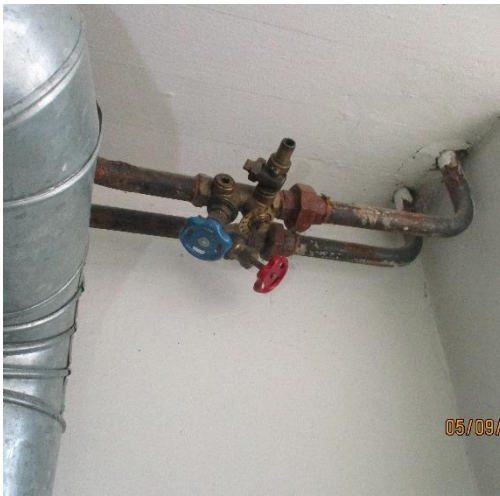
Kuva 5.9 Tutkimusten yhteydessä todettiin lämpöjohtoputkien asennuksia, joissa putket ovat suoraan kosketuksissa kiviaineisiin materiaaleihin.
