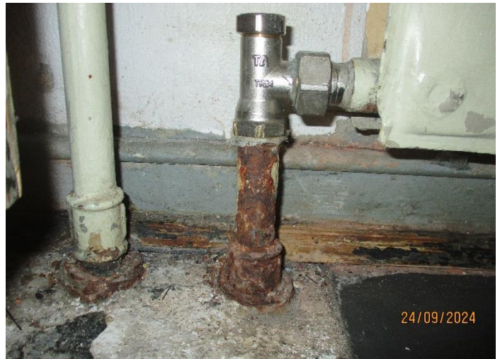
Kuva 5.10 Mikäli rakenteisiin asennetut teräsputket joutuvat tekemisiin putken ulkopuolisen kosteuden kanssa, voi putkien tekninen käyttöikä lyhentyä merkittävästi.
