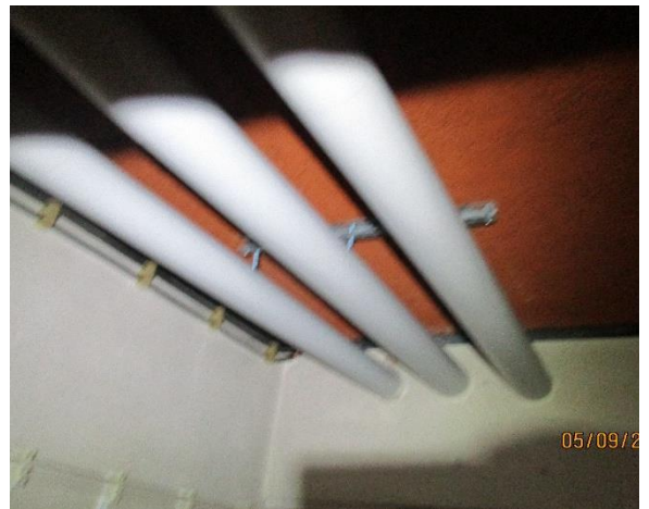
Kuva 6.5 Käyttövesiputkistoa kellarikerroksen tiloissa. Putket on kannakoitu kattorakenteisiin ja putkien eristys päällystetty PVC-kourulla.
