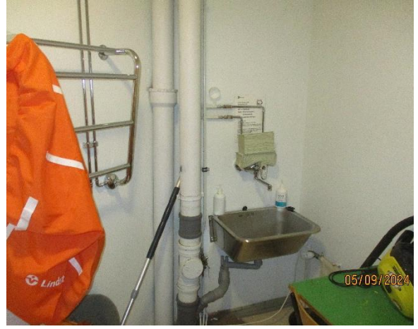
Kuva 6.9 2 kerroksen siivoustilassa muovinen sekä valurautainen pystyviemäri.
