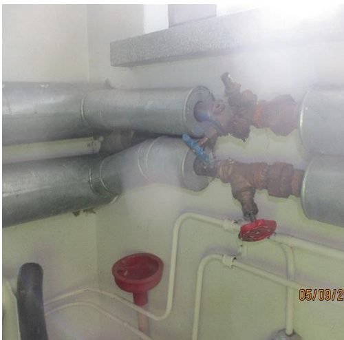
Kuva 5.5 Lämmitysverkoston vanhempia putkistovenntiileitä A-osalla.
