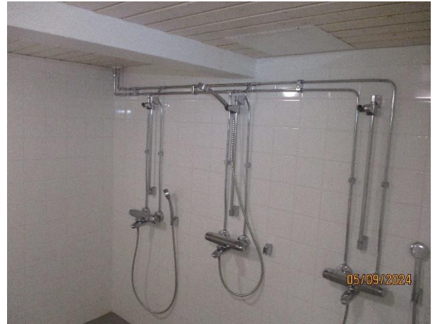
Kuva 6.13 Kellarin pesuhuoneiden suihkuhanoja, Oras. Kalusteet uusittu peruskorjauksessa
