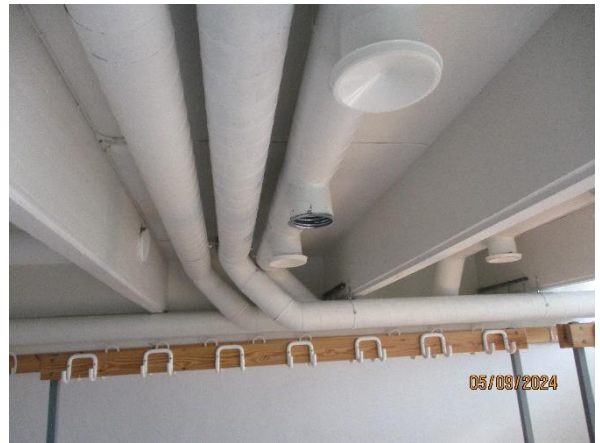
Kuva 8.10 Kellarin pukuhuonetilassa näkyvillä olevat kanavat
