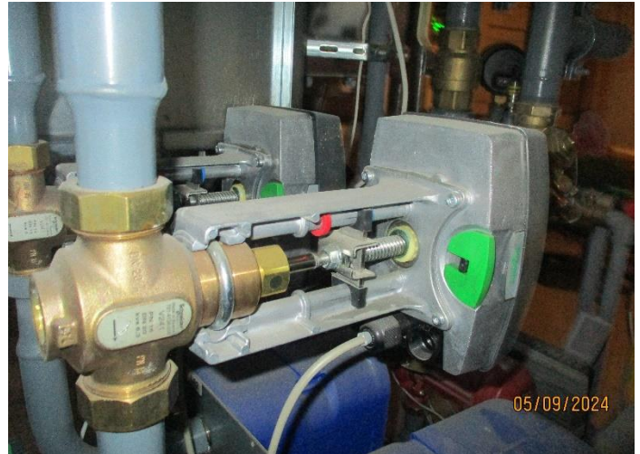
Kuva 5.4 Verkostojen moottoriventtiilit ovat vuodelta 2014 alajakokeskuspakettiin sisältyneitä asennuksia.
