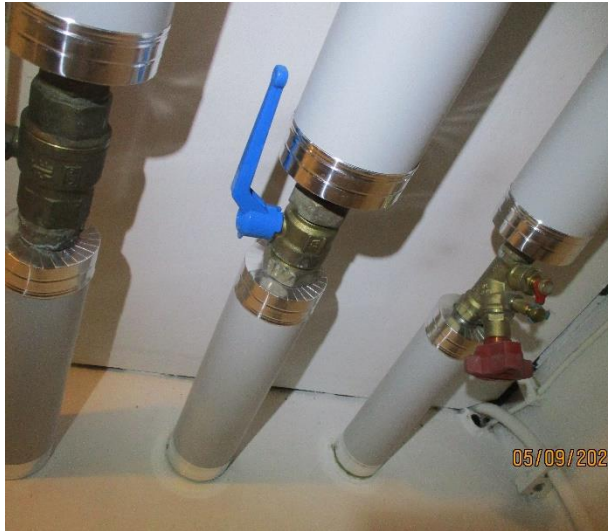
Kuva 6.6 Käyttövesiverkoston linjan sulku- ja säätöventtiilit.
