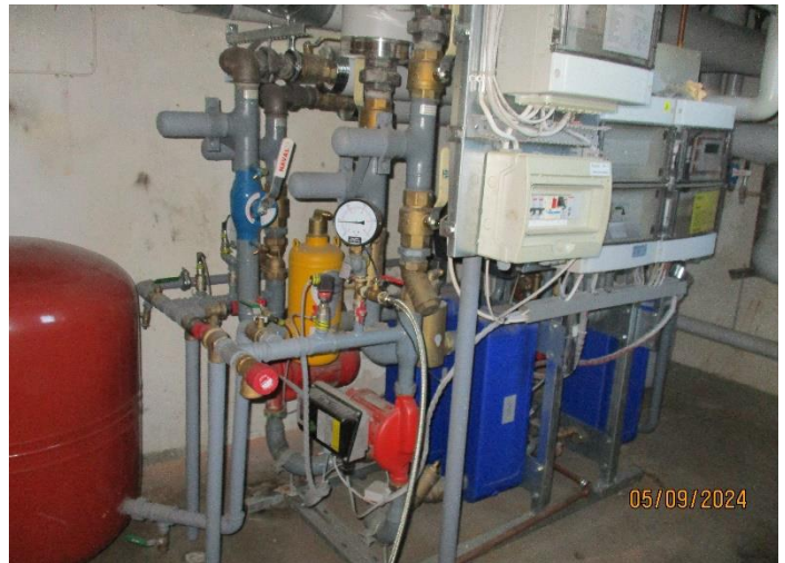
Kuva 5.2 Kaukolämmön ala-jakokeskus lämmönjako-huoneessa.
