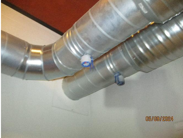
Kuva 8.11 Kanavistossa käytetyt säätöpellit ovat nykyaikaisia
